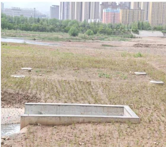
虹吸缓冲槽及蓄水池
